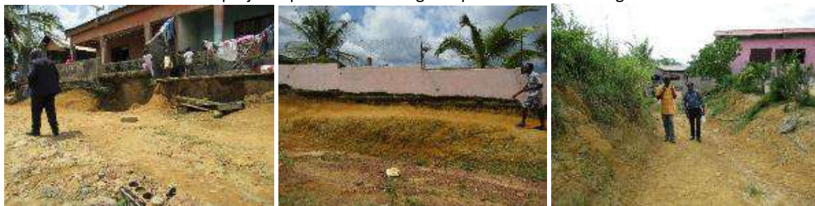
Une vue du phénomène d'érosion au lieu Manguier. Vue des dénivelés causés par l'érosion à l'école Don Bosco
