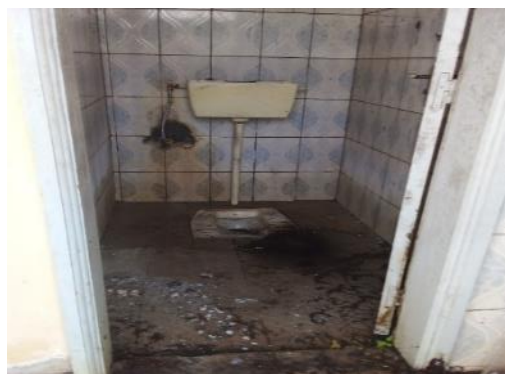
Etat d'insalubrité d'un sanitaire du lycée
