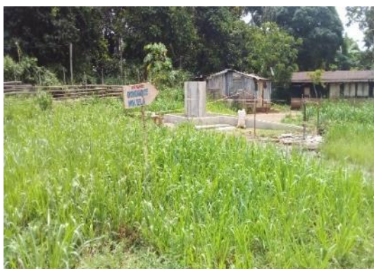
Photo 15 : Vue d'une pompe hydraulique à Bakoumba
