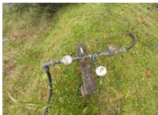
Photo 30 : Vue d'un compteur d'adduction d'eau potable à Cocobeach
