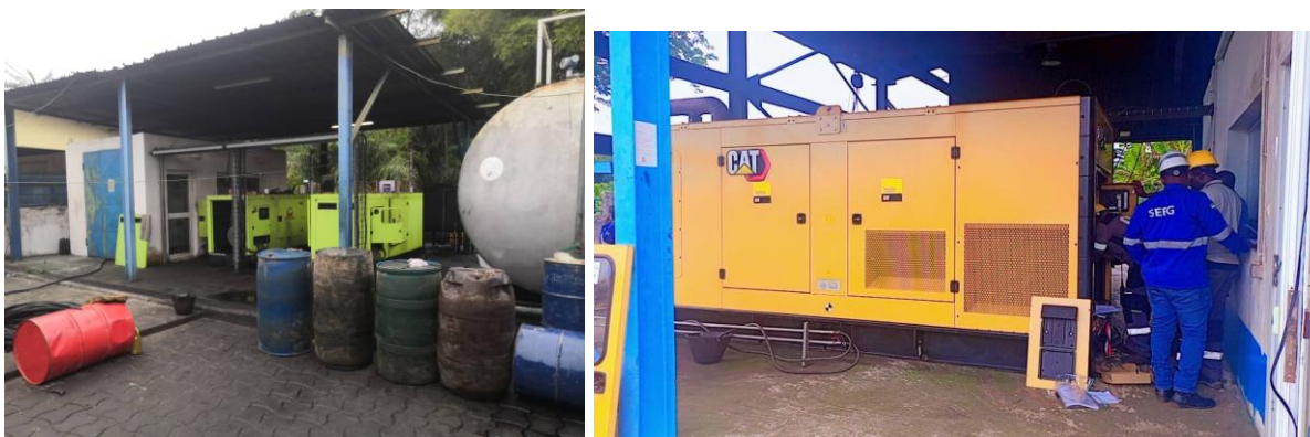
Planche photos 33 : Groupes électrogènes, fûts, citernes de stockage de gasoil de la SEEG.
