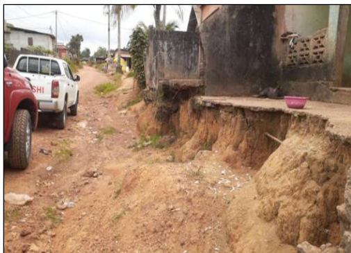
Photo n°1 : érosion d'une habitation
